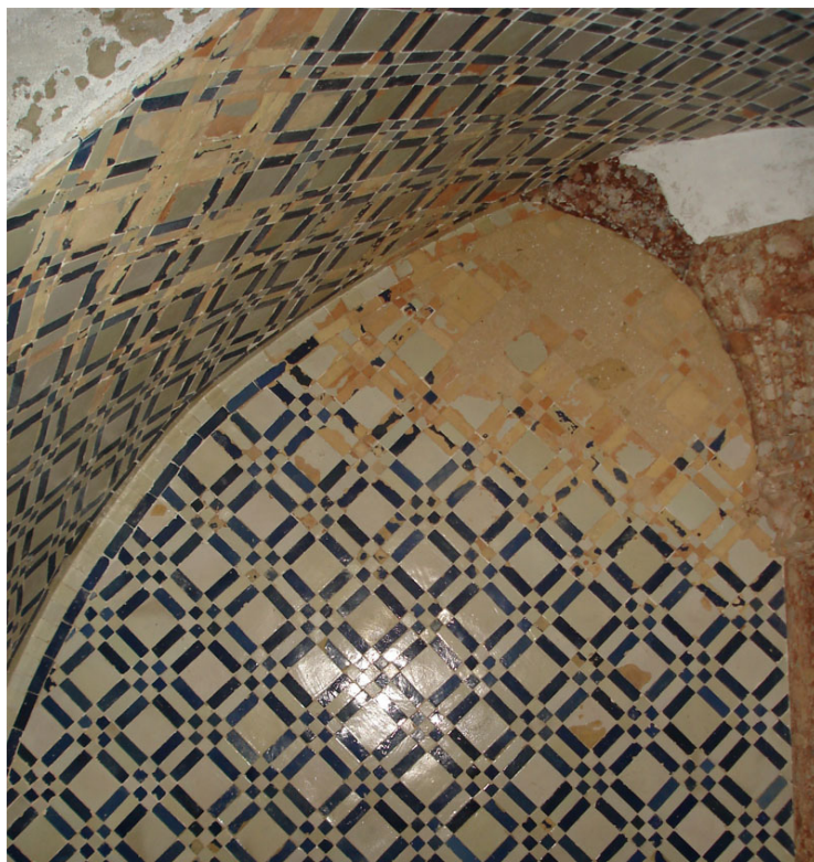
Figura 3- Aspecto do interior com zona de infiltração de águas pluviais
