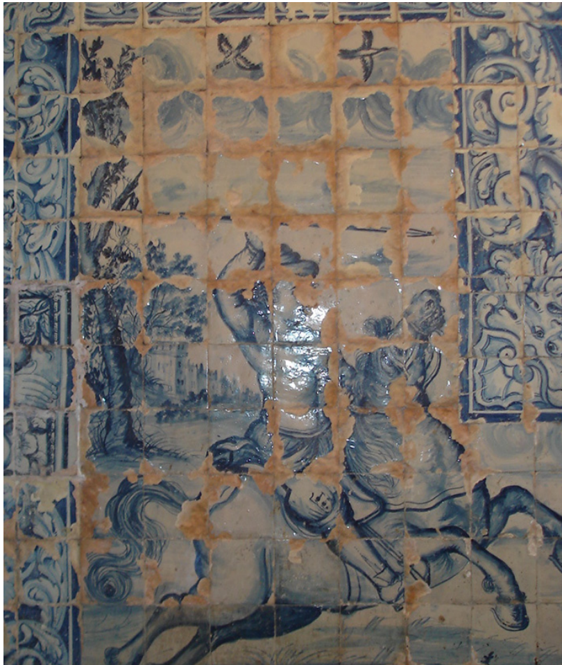
Figura 24- Perda de vidrado num painel- note-se a chacota avermelhada
