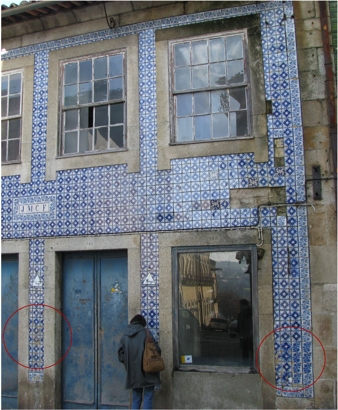
Figura 16- Fachada com as zonas afectadas pela patologia da figura 17 indicadas
