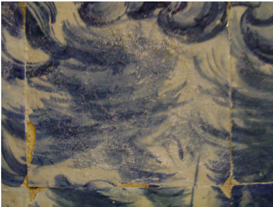
Figura 13- Aparente ocorrência de eflorescências sobre o vidrado de um azulejo apenas
