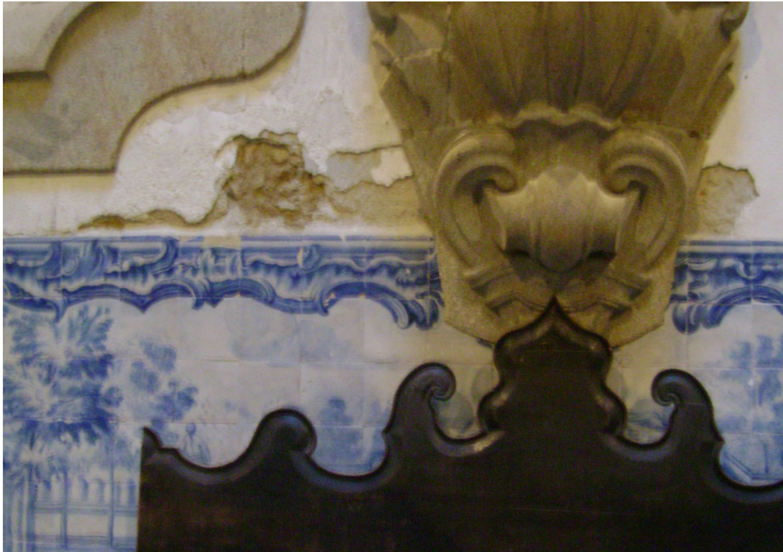
Figura 9- Danos de cristalização sobre um dos painéis de azulejos
