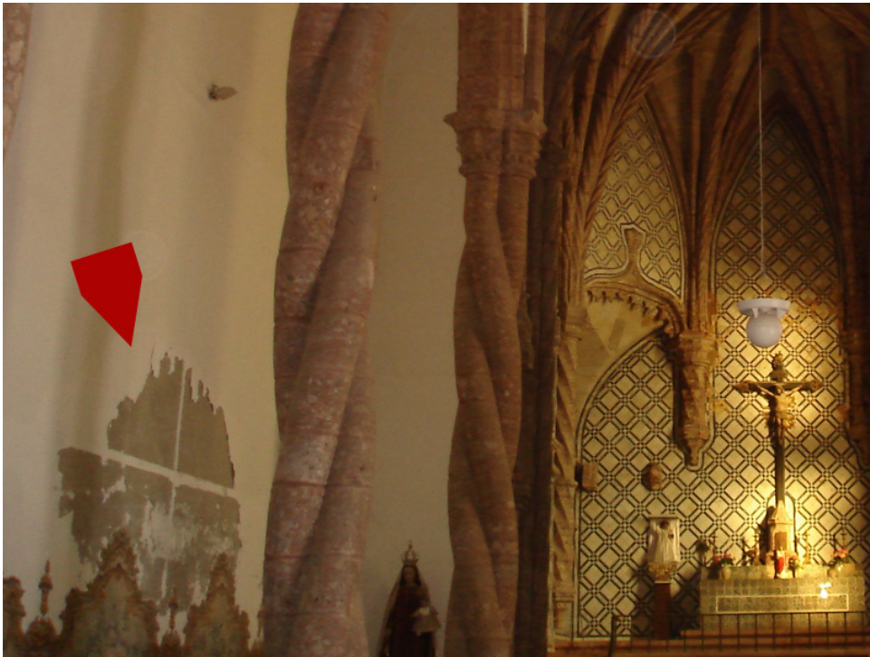
Figura 1- Aspecto do interior com zona húmida e de possível cristalização salina
